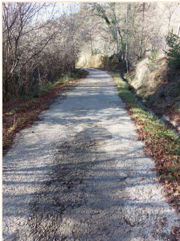
Tram formigonat degradat
