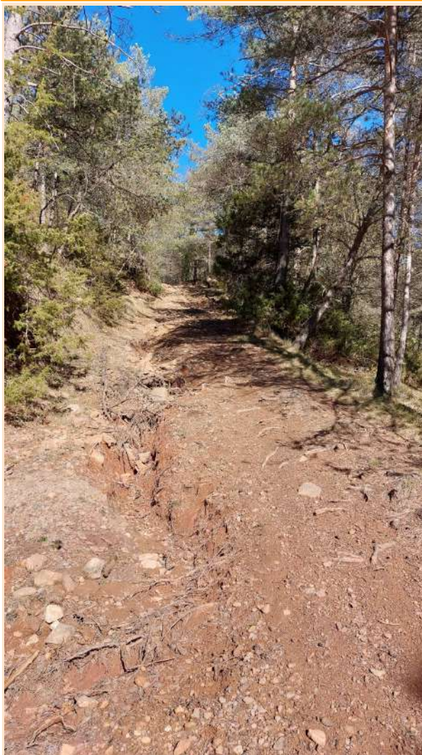
Tram en mal estat (cota 880m)
