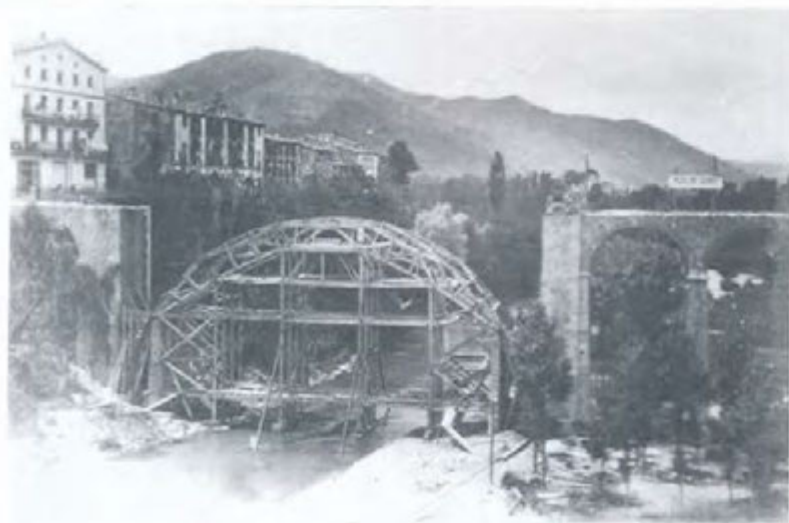
Construcció de la cindra per a l'arc de formigó armat. Juliol de 1919.
